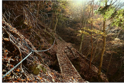
作業完了後の様子。 写真では見えないが、橋の奥は先に整備した谷地形の場所。 この谷地形の場所に設置したロープを老朽化した橋をさらに越えて繋げる事ができた。
